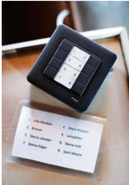
Knappsatsen styr all reglering av ljuset i kyrkorummet och även klockringningen.
