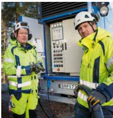
Reservkraft behövs alltid vid stora evenemang. Jan-Olov Gullnäs och Tony Östh från Falu Elnät kollar ett av reservaggregaten.
